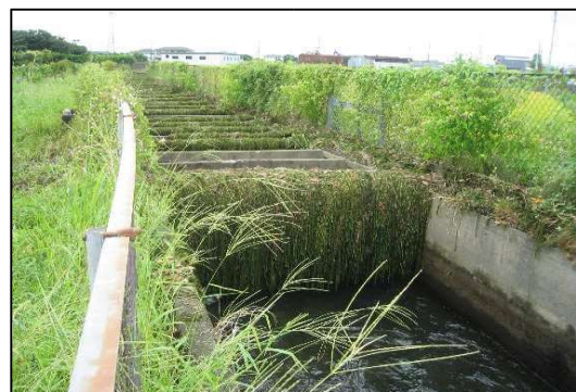
溢水後の状況（R2.9 月）
