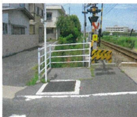
【踏切部暗渠内水門の自動化】
