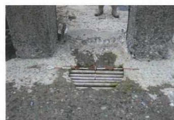
【油圧パイプが露出】
