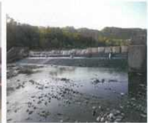
【ゲートの流失(仮設)】
