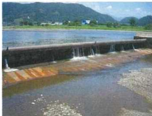
【ゲートから漏水】
