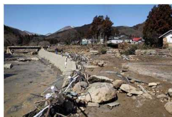
洪水による橋の被害
